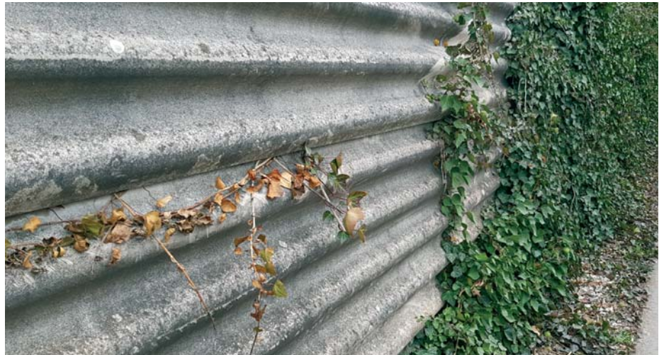
Dieser Sichtschutz ist eine Zeitbombe und ein Fall für die Entsorgung. Foto: A. Dreilich
