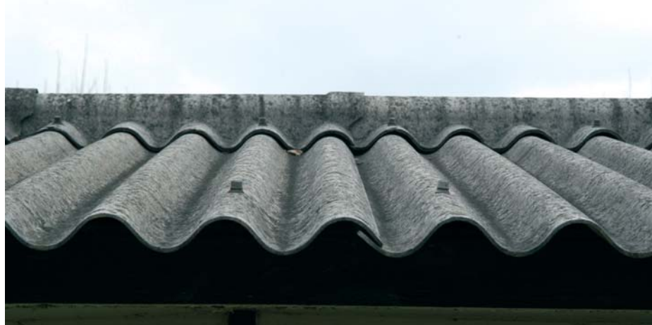
Nichts für Heimwerker: Gefahrstoff auf dem Laubendach.
